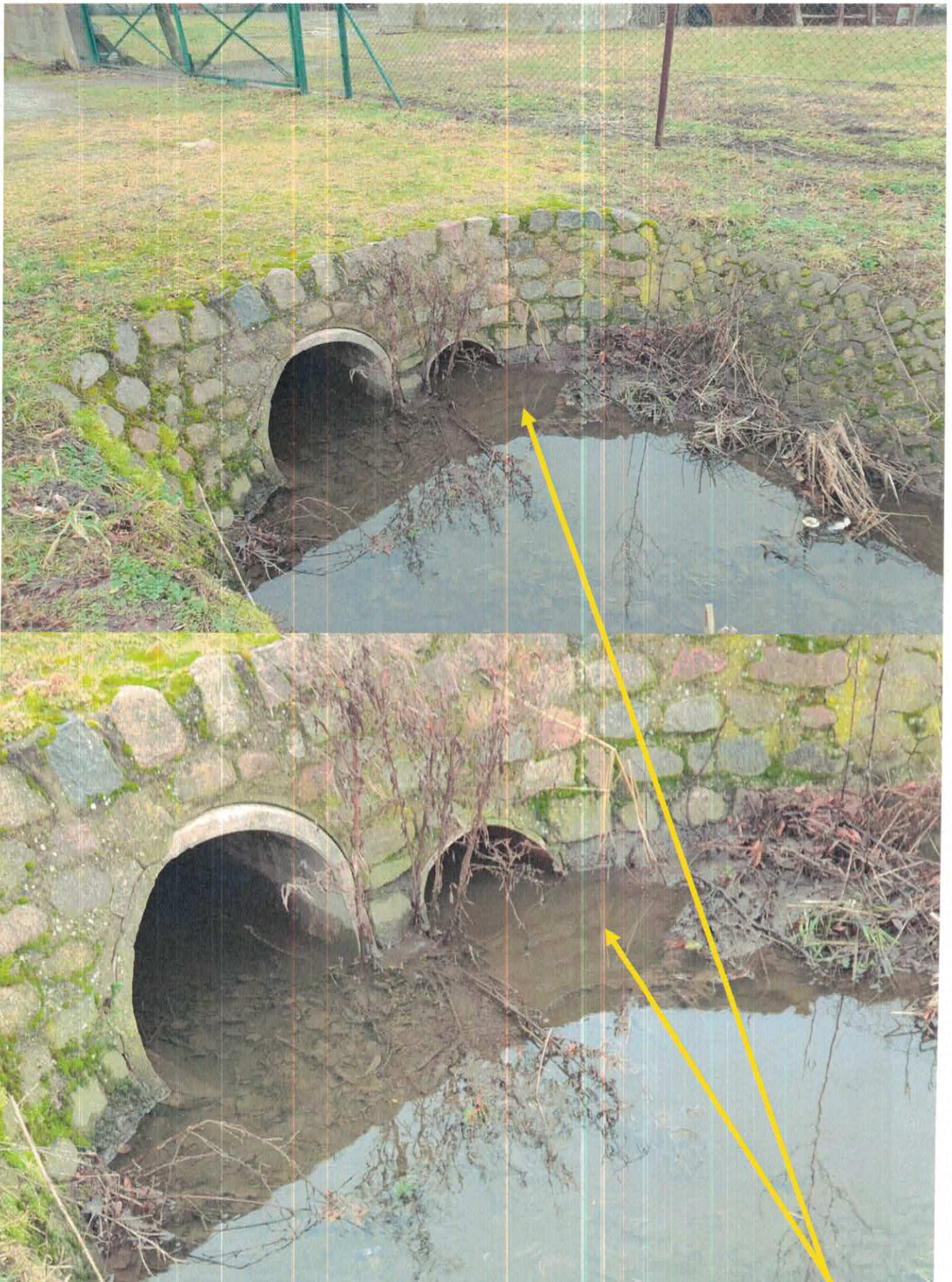
Zdjęcie od nr 9 nr do nr 12 - Widok (z dnia 07 lutego 2022 do dnia 09 lutego 2022r.) wypływu mniejszej ilości stężenia zanieczyszczonych wód – ścieków z drugiej rury przepustu drogowego położonego pod drogą powiatową – ulicą Św. Walentego do rowu melioracyjnego (działka nr 420, itd.) w kierunku oczyszczalni ścieków w Wysokiej.
