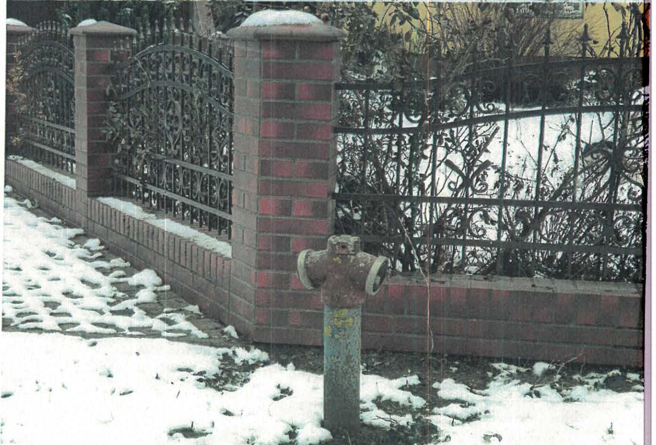
Zdjęcie nr 12 i nr 13 - Widok stanu hydrantu ppoż. w miejscowości Stare.
