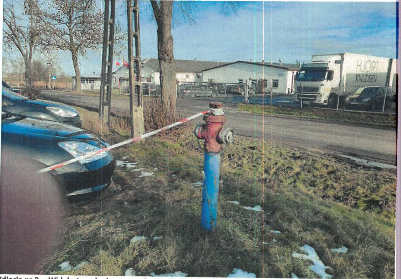
Zdjęcie nr 8 - Widok stanu hydrantu ppoż. przy drodze nr 190 naprzeciwko firmy Hjort Knudsen Polen Sp. z o.o. m. Wysoczka.
