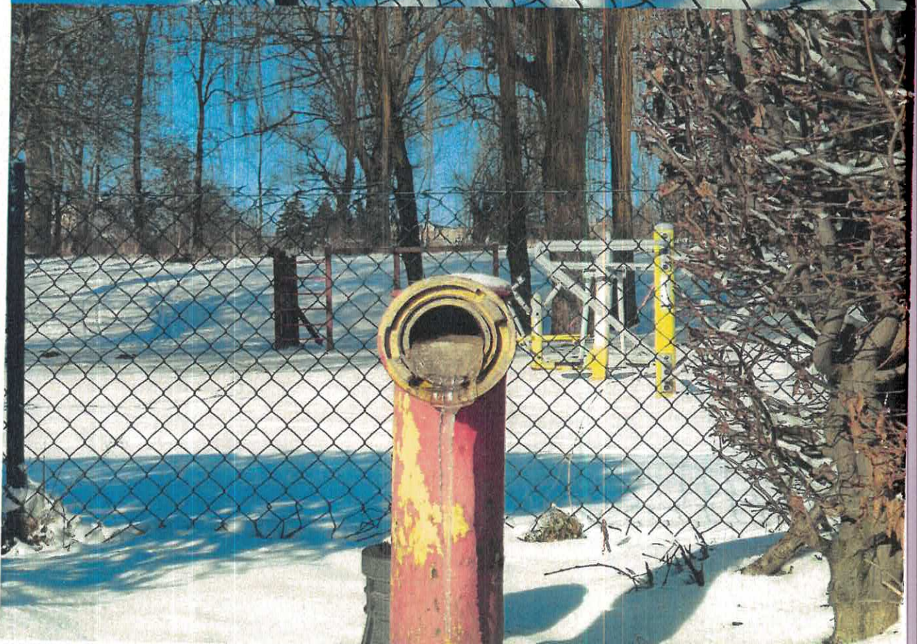
Zdjęcie nr 3 i nr 4 - Widok zamrożonego hydrantu ppoż. wody przopuszczalnie w związku z nieszczelnością zasowy (w sąsiedztwie placu zabaw) przy ul. Kościelnej w Wysokiej.
