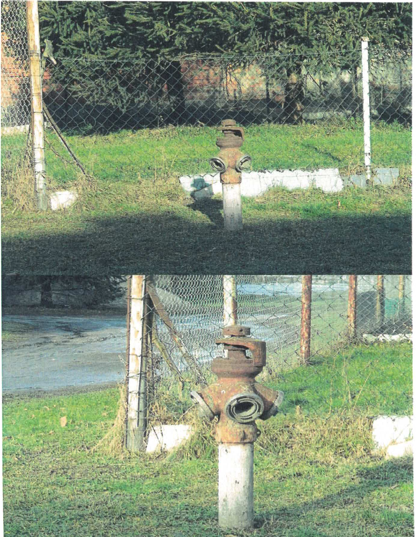
Zdjęcie nr 17, nr 18 i nr 19 - Widok stanu hydrantu poż. w miejscowości Czajcze.
