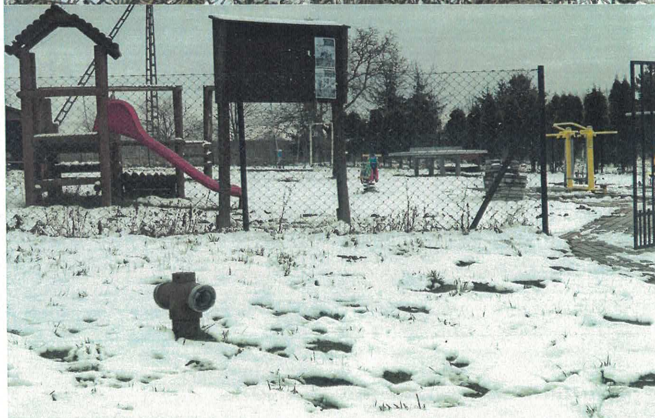
Zdjęcie nr 12 i nr 13 - Widok stanu hydrantu ppoż. w miejscowości Stare.
