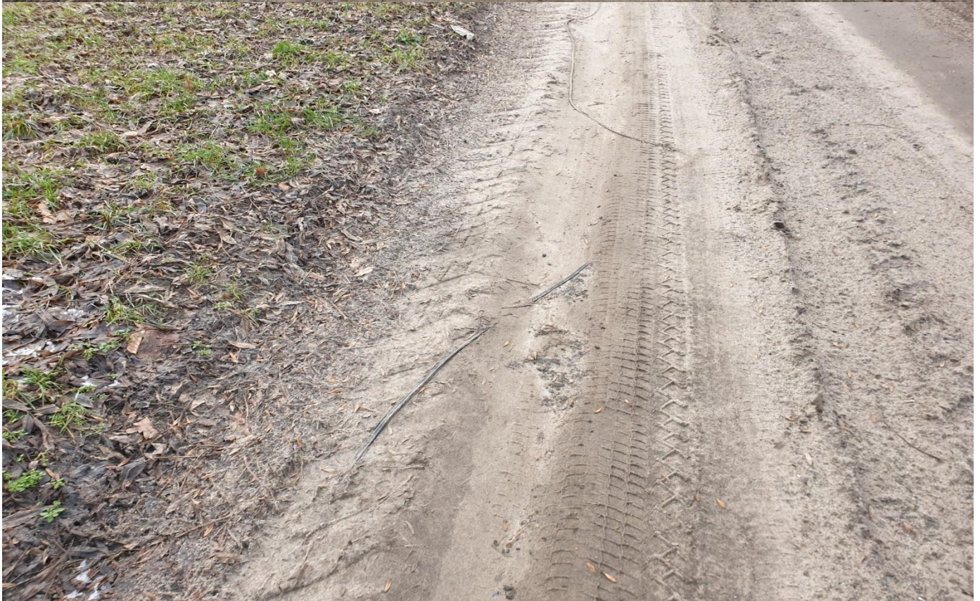
Zdjęcia od nr 1 nr do nr 10 - Widok pozostałości słupów teletechnicznych i leżących resztek kabli na drodze powiatowej Rudna - Stare i przy drodze Stare – Żelgniewo. Opracował: Henryk Stańczyk, dnia 27.01.2021r.
